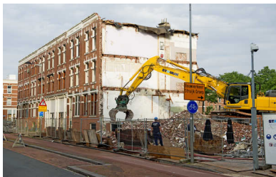
In de Afrikaanderwijk (links) en in Katendrecht in Rotterdam is veel gesloopt. De gemeente wil meer goedkope woningen slopen.
